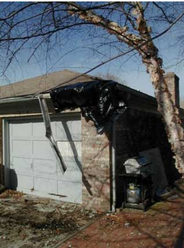
Descarga eléctrica atmosférica a árbol y casa.
